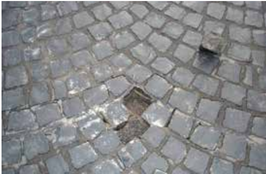
Figur V1.4 Manglende permeabilitet i underliggende bundne lag fører til at stein løsner (foto: René Kierstein)
