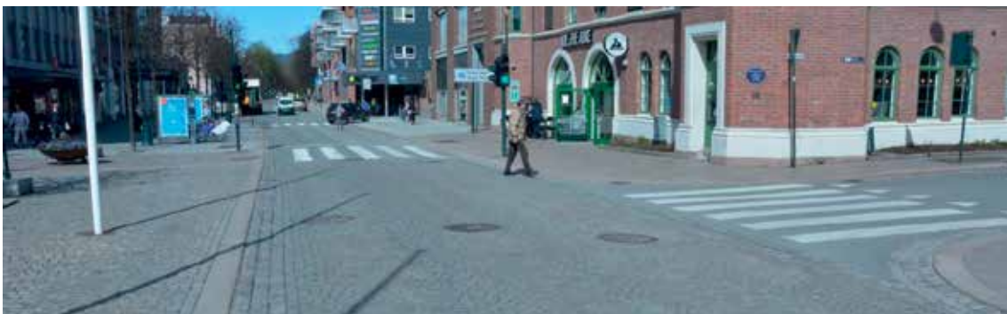
Figur 5.1 Velfungerende dekke av smågatestein ubundet utført i trafikkert sentrumsgate (foto: René Kierstein)
