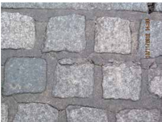
Figur V1.3 Fugemørtel har løsnet fra stein (foto: René Kierstein)
