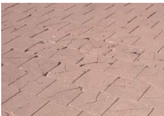
Lokale skader etter arbeidsmaskin
