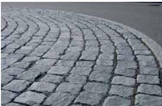
Figur V1.10 Storgatestein står ustødig og skjevt i overkjørbar del av en rundkjøring (foto: René Kierstein)
